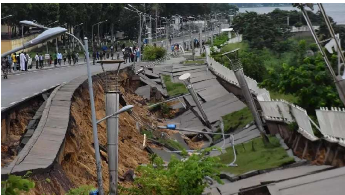
Figure 11. Collapse of part of La Corniche overlooking the Congo River in Brazzaville, 9 January 2020. Source: RFI/ Loïcia Martial, https://www.rfi.fr/fr/afrique/20200110-congo-b-eboulements-touche-centre-ville-brazzaville
